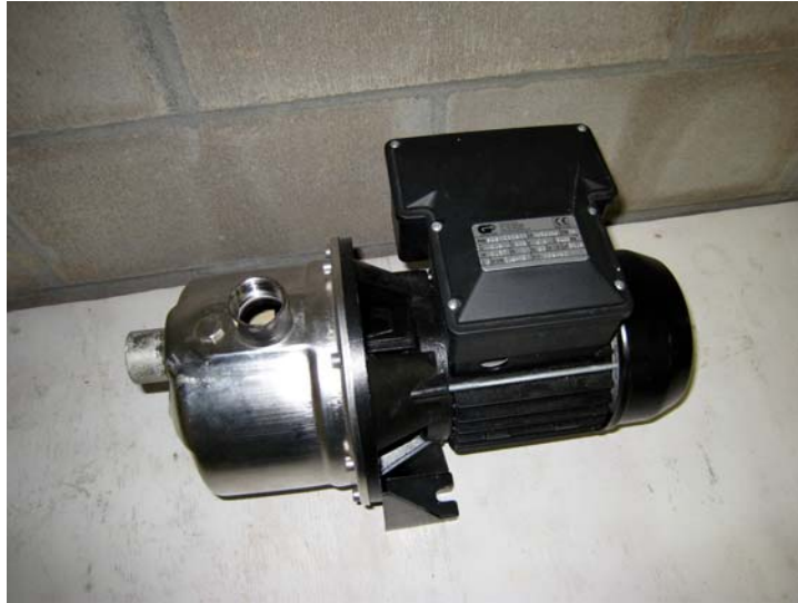
Ilustración 7.3.2-1 Sistema de bomba
