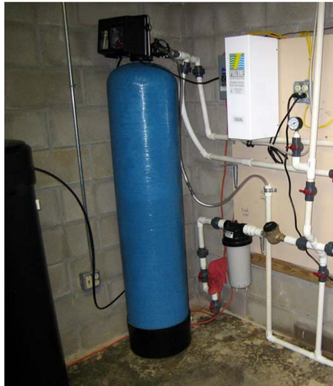
Ilustración 7.5.3-2 Descalcificador, tanque de salmuera y todos los tubos incluyendo el tubo de drenaje del descalcificador.
