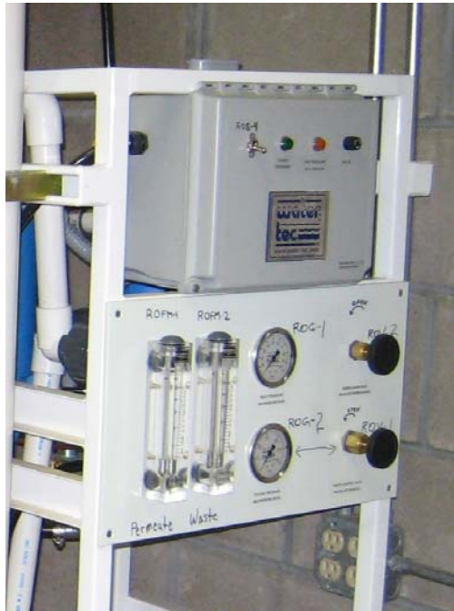
Ilustración 7.12-1 Panel de control del RO, válvula, indicadores y metros para flujo
