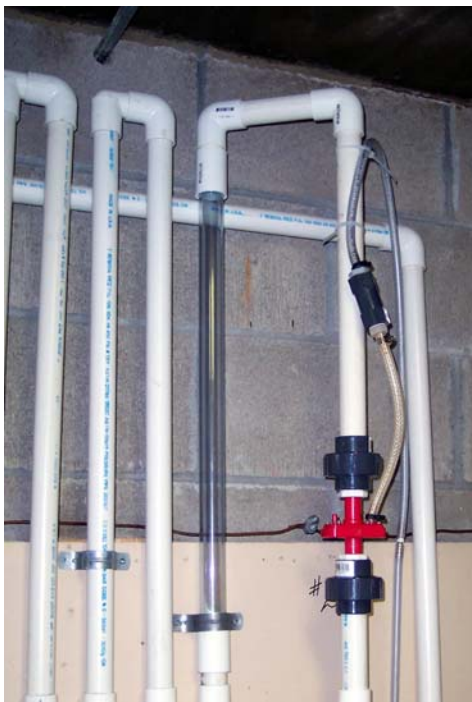
Ilustración 7.7-2 Ozone clear pipe and venturi
