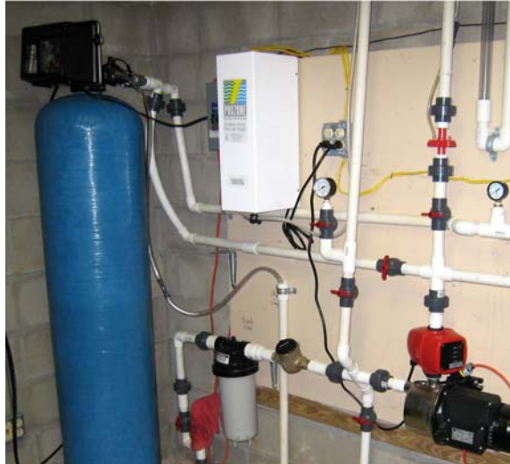
Ilustración 7.5-1 Plomería del descalcificador desde la entrada de agua sin tratar
