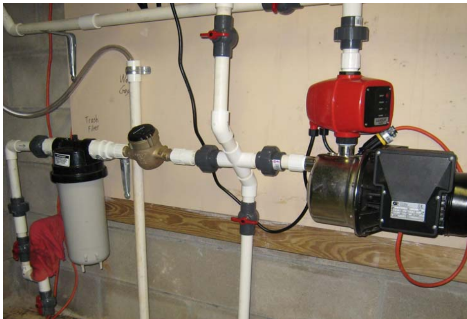
Ilustración 7.3-1 Entrada del agua sin tratar
