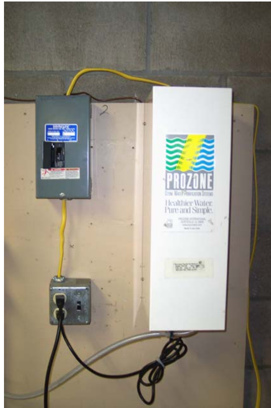
Ilustración 7.8.1-1 Servicio eléctrico y el generador de ozono
