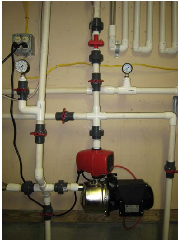
Ilustración 7.3.3-1 Entrada de agua a la bomba, regulador y tubería completa.
