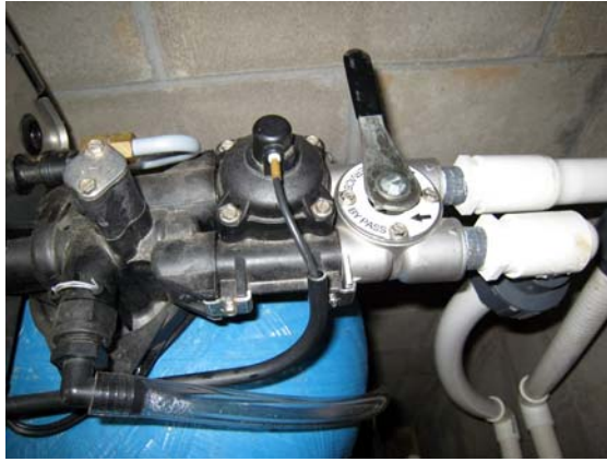
Ilustración 7.5.3-1 Válvula de desvío y tubería de descalcificador. Observe la válvula en la posición “Bypass”. Observe el tubo transparente en la parte baja.
